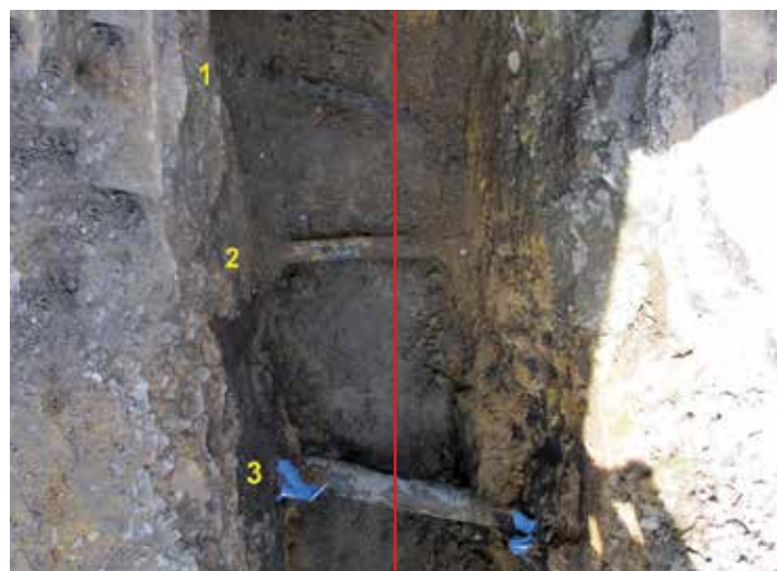
Skrzyżowanie ulic Michejdy i Matejki. Podczas robót budowlanych odkryto 3 niezainwentaryzowane rurociągi. Czerwona linia - planowany przebieg budowanej kanalizacji.
